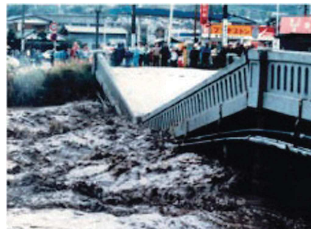
写真4 土石流で壊れた橋(富士宮市内, 1979年 撮影, 国土交通省富士砂防事務所提供 静岡県総合防災センター「土石流の流出と山麓の暮らし」 http://sakuya.ed.shizuoka.ac.jp/sbosai/fuji/wakaru/004.html
